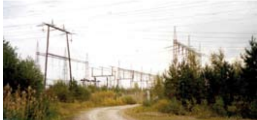
Kuva 3. Valokuva esimerkkisähköaseman ulkopuolelta.
