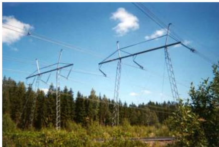
Kuva 5.1. Valokuva 400 kV voimajohdon LM-1 portaalipylväistä.
