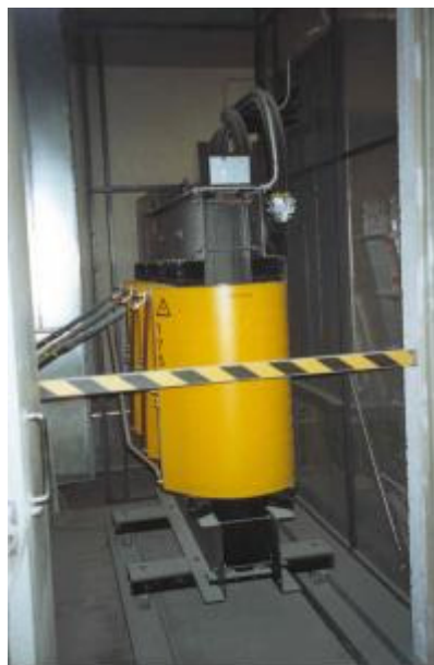
Kuva 6.7. Valokuva muuntamosta LM-4.
