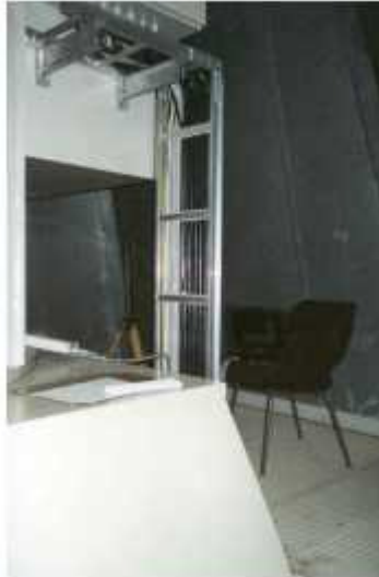
Kuva 5.1. Valokuva vesivoimalaitoksen LM-1 turbiinin suojakuoren sisältä.
