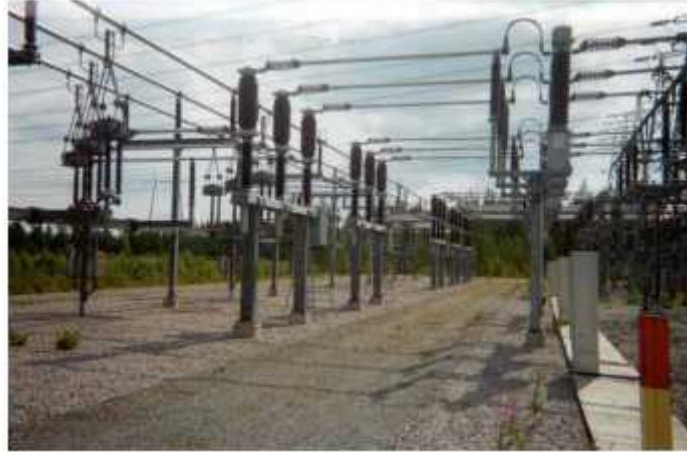
Kuva 6.21. Valokuva sähköaseman LM-5 pääkiskostosta (110 kV).
