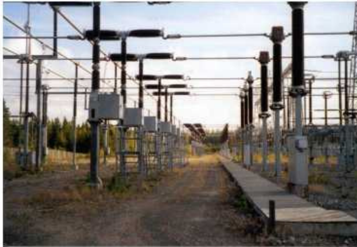
Kuva 6.29. Valokuva sähköasemasta LM-7.
