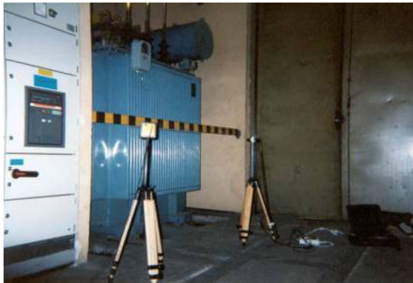
Kuva 7.26. Valokuva teollisuuskohteen LM-13 muuntamosta (metalliteollisuus).
