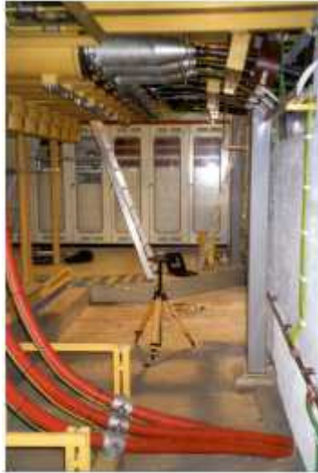
Kuva 6.7. Valokuva sähköaseman LM-3 sähkö- ja magneettikentän mittaustilanteesta. Figure 6.7. Photograph from the electric and magnetic measurements of the substation LM-3.
