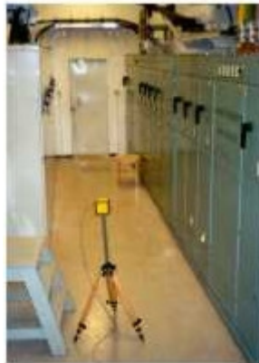
Kuva 4.1. Esimerkki sähkökenttämittauksesta Wandel&Goltermann EFA-3 mittarilla.
