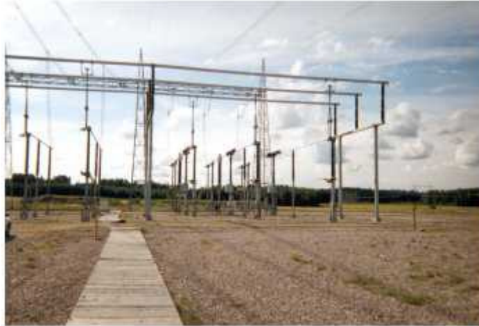
Kuva 6.35. Valokuva säkösäman LM-8 pääkiskoista ja kytkinkentästä.
