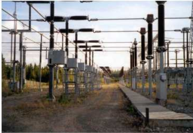
Kuva 6.1. Valokuva 400 kV sähköaseman LM-2 kytkinkentästä.
