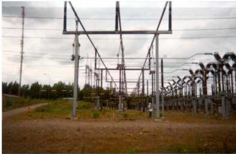
Kuva 6.13. Valokuva sähköaseman LM-4 pääkiskostosta.
