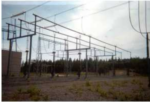
Kuva 6.17. Valokuva sähköaseman LM-5 pääkiskostosta (400 kV).
