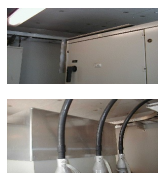
Kuva 6.27. Valokuva muuntamon H302 pienjännitekeskuksen päälle ulottuvasta suojakotelosta muutostyön jälkeen.
